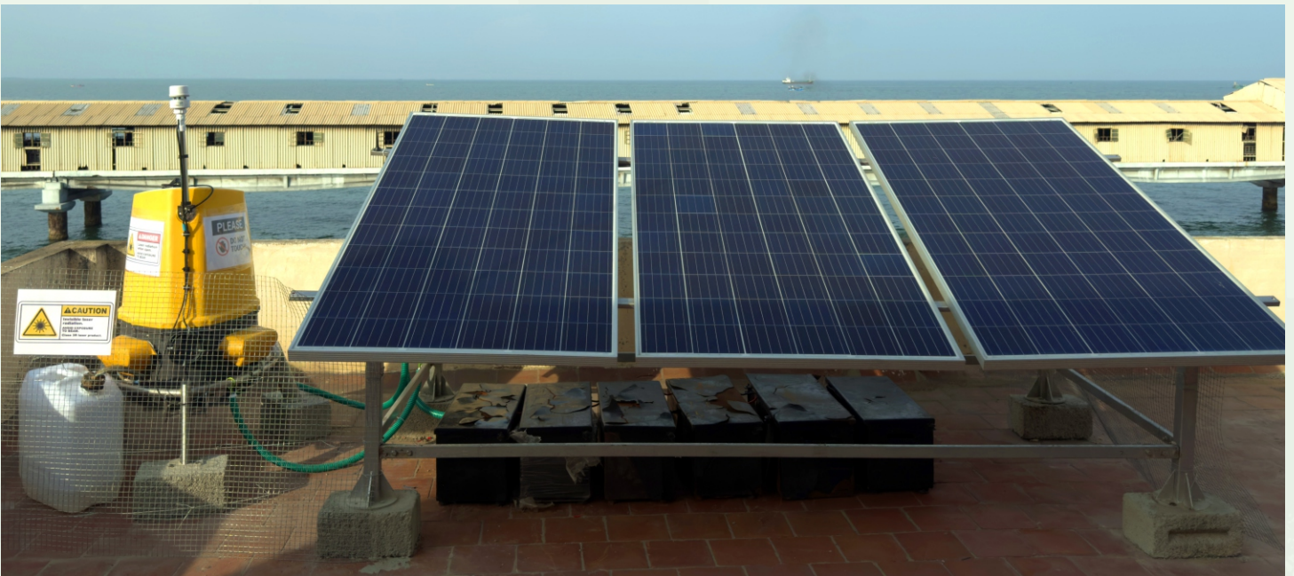
VOC पोर्ट_2, स्थल : ऑयल जेट्टी के पास इलेक्ट्रिकल सबस्टेशन छत
