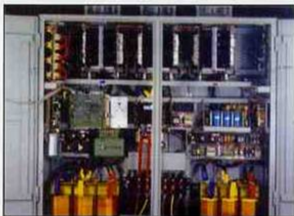
स्वदेशी रूप में डिजाइन और विकसित किया गया इंटेलिजेंट विंड कंट्रोलर, जिसे मुप्पनडल, तमिलनाडु में पवन टरबाइन में स्थापित किया गया है।
