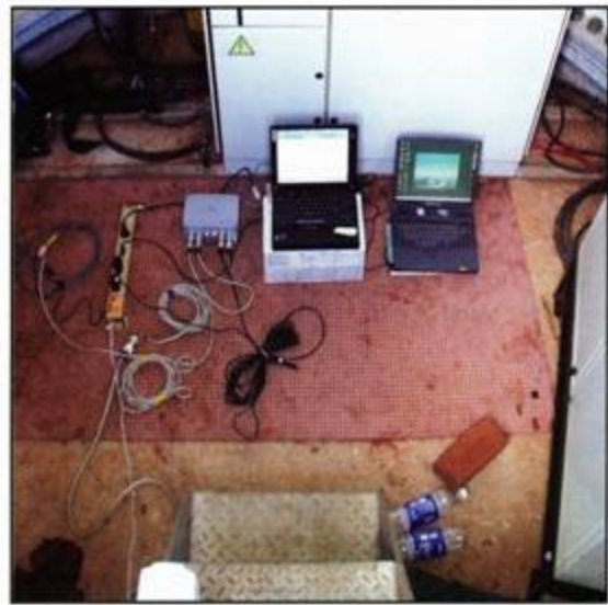
वेस्टास आरआरबी इंडिया लि. के 47 मी. पवन टरबाइन के साथ 39/500 किवा. का स्थल पर निरीक्षण और विचलन कुशलता परीक्षण
