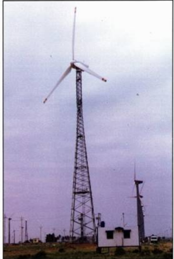
डब्ल्यूटीटीएस, कयाथार में परीक्षण के अधीन 250 किवा. पवन टरबाइन
