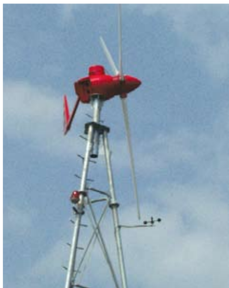
5 kW बैटरी चार्जर पवन-सौर-पुंगम तेल त्रि-उत्पादन व्यवस्था
