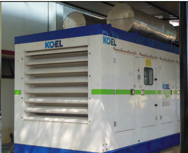
380 kVA Diesel Generator
